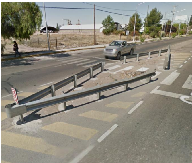
Figura 3. Defensas metálicas a reemplazar por defensa de H° A° tipo "Medio New Jersey"
