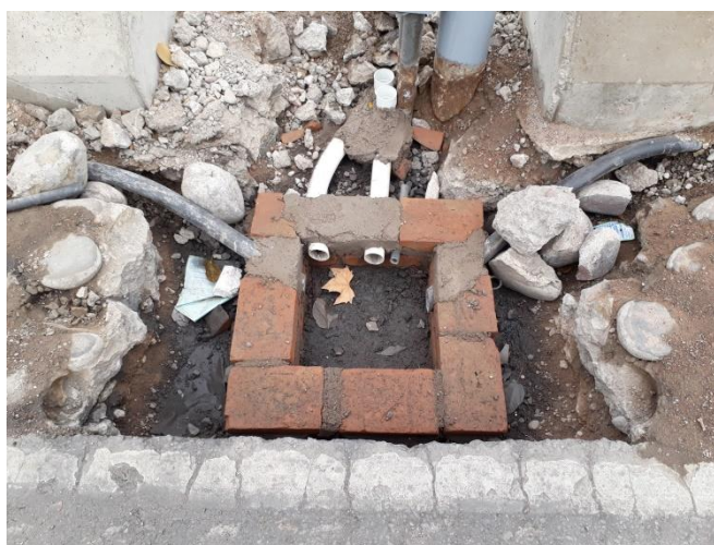
Figura 24. Cámara de acceso a columna de iluminación
