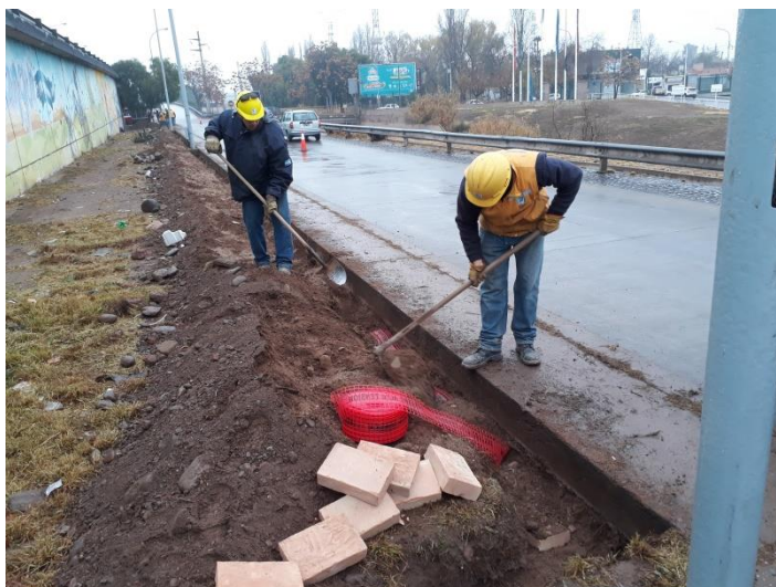
Figura 28. Colocación de cinta de peligro de advertencia
