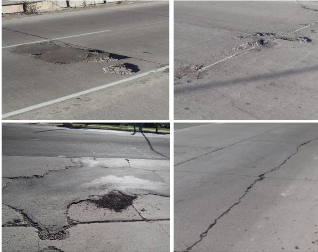
Figura 6. Losas de hormigón a reparar o reconstruir
