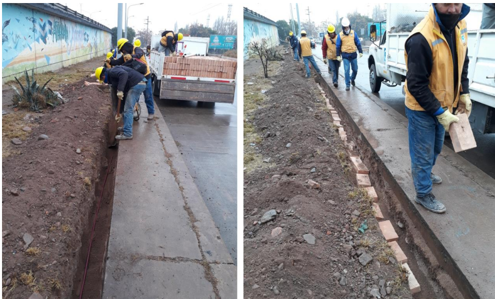
Figura 27. Primeras capas de protección de cableado con suelo y una corrida de ladrillos
