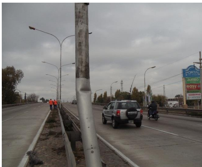
Figura 5. Columna de iluminación dañada a reemplazar
