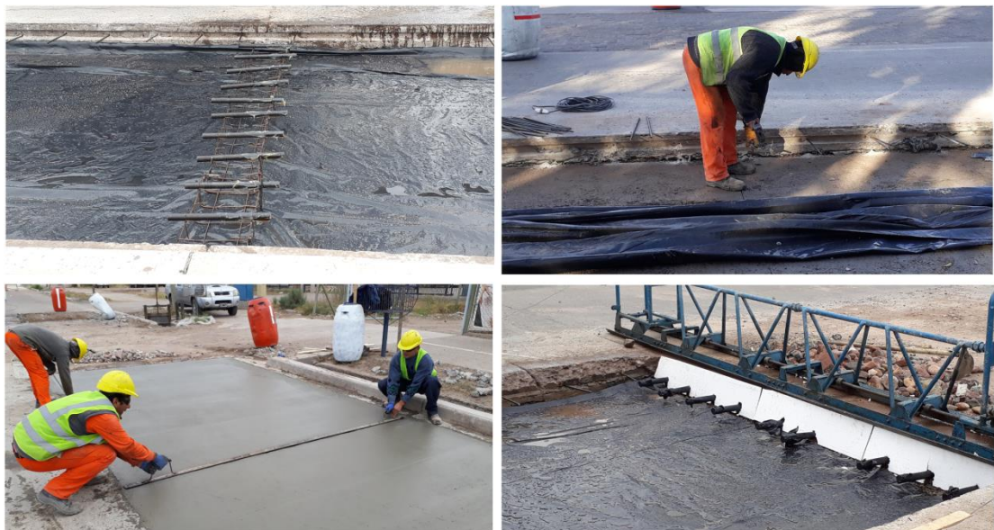
Figura 21. Pasadores, colocación de barras de unión, materialización de junta de contracción y de junta de dilatación
