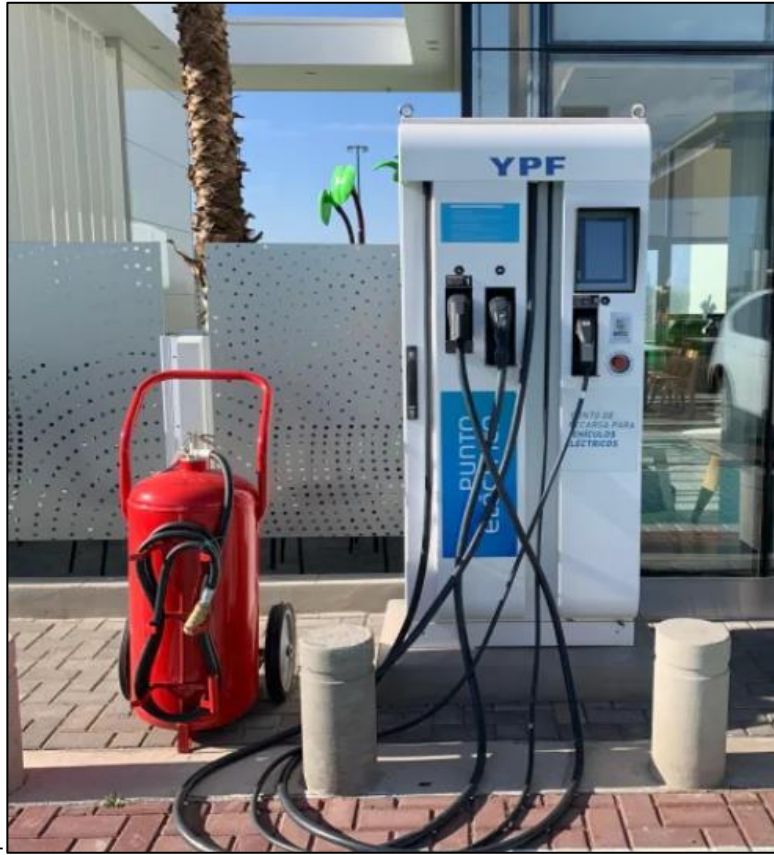
Figura 21. Estación de carga YPF
